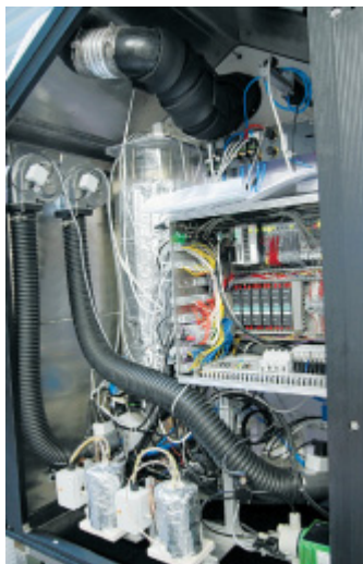
Prall gefüllt mit Technik: Die Abdeckung des neuen Prüfschranks wird ganz zuletzt angebracht.
